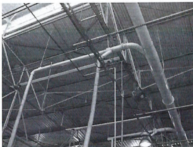
Figura 33 - Mangotes fixados nas derivações da tubulação.
