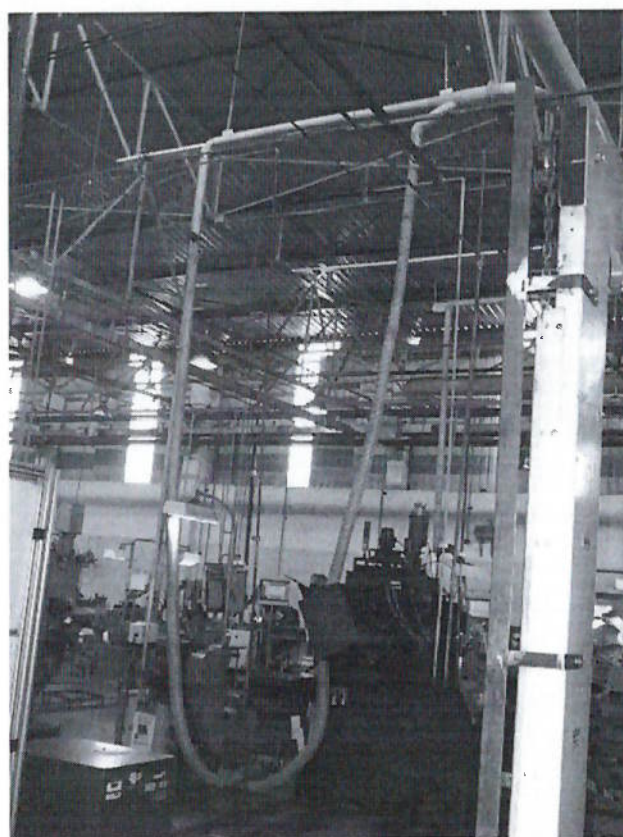
Figura 34 - Visão geral dos mangotes, partindo da tubulação e fixada às moegas.
