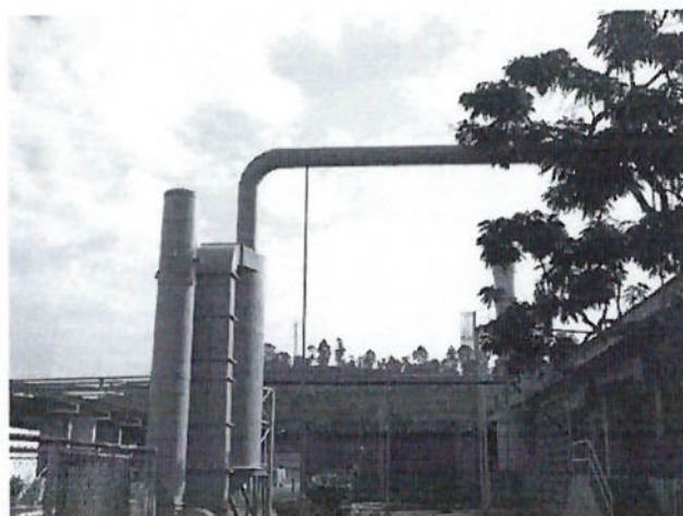
Figura 29 – Vista lateral do sistema de monitoramento montado.
