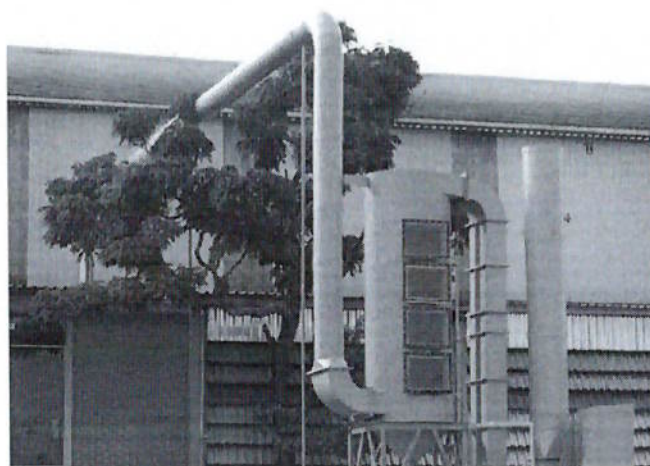
Figura 30 – Vista frontal do sistema de monitoramento montado.
