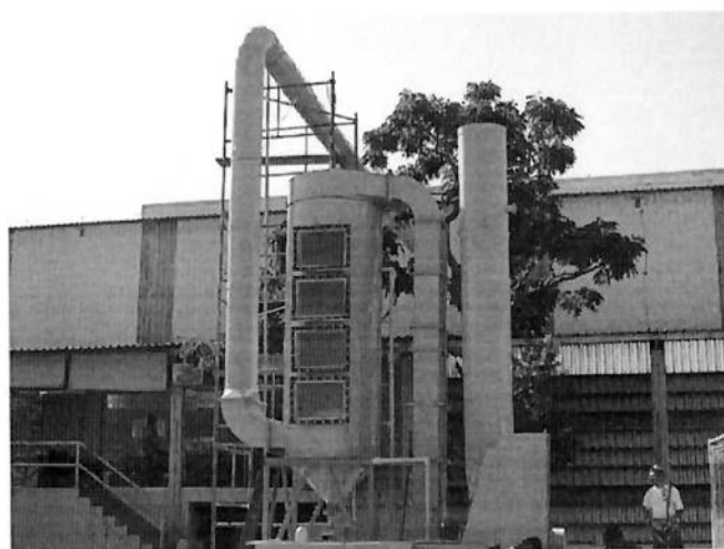
Figura 28 – Vista frontal do sistema de monitoramento em montagem.
